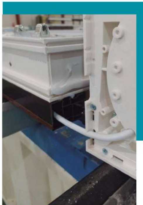
Le câble ressort proprement dans la zone du DE-2, à l'arrière du coffre.
